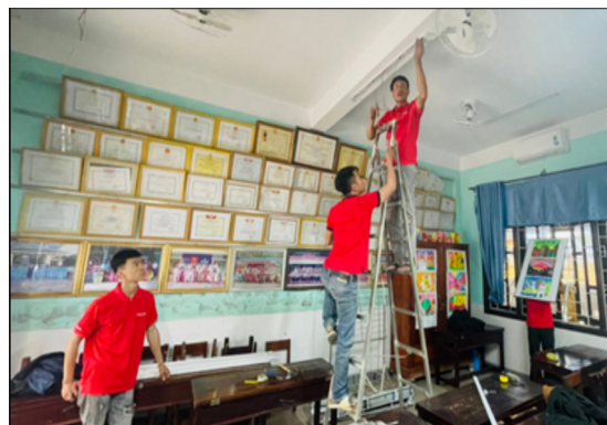
Kỹ thuật viên Công ty Cổ phần Bóng đèn Điện Quang đang lắp đặt hệ thống chiếu sáng mới tại các trường học trên địa bàn TP. Huế. Ảnh: Nữ Phan.
