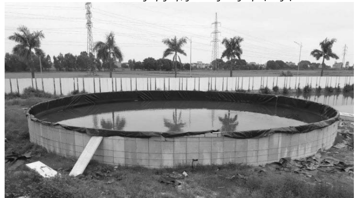
Bể xử lý đường kính 20m, xây dựng bằng BTCT chế tạo sẵn, lắp ghép, trong lót HDPE
