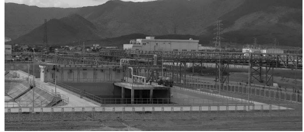
Trạm bơm nước thải tuần hoàn trong cụm hồ kiểm soát sự cố
