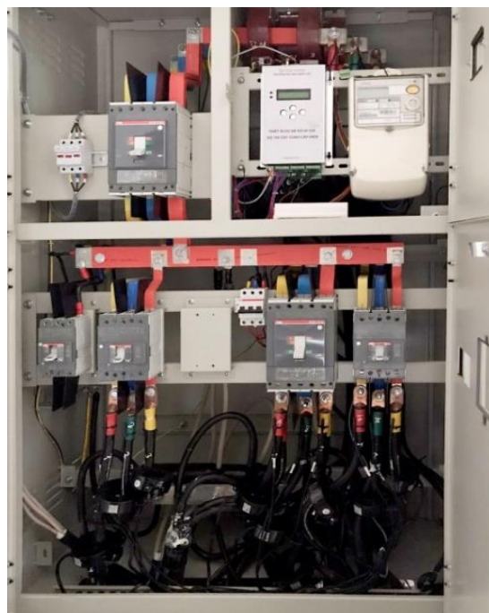
Hình 14. Thiết bị đánh giá ĐTC cung cấp điện của LPP
