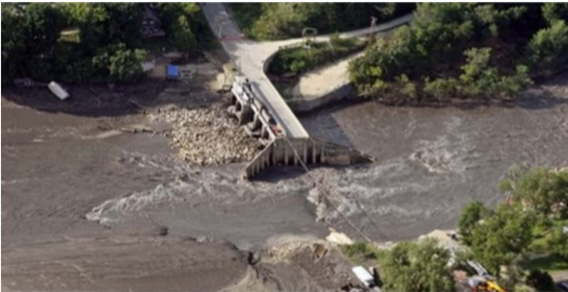
Hình 1. 3. Phần đập đất bị xói hết, chỉ còn lại phần bê tông
