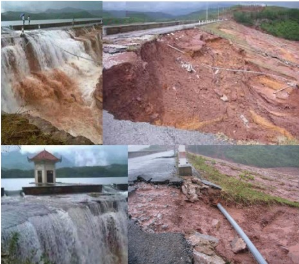
Hình 4. 3. Đập chính bị hư hại nặng do nước tràn qua
