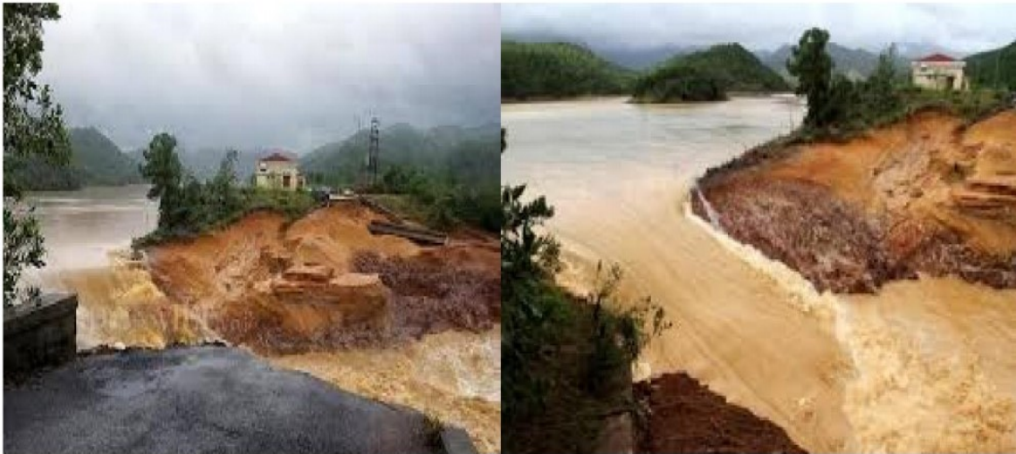
Hình 4. 4. Đập phụ số 2 bị vỡ
