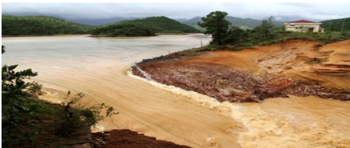
Hình 1. 7. Vỡ đập phụ số 2, Đầm Hà Động – Quảng Ninh, ngày 30/10/2014 (nguồn Internet)
